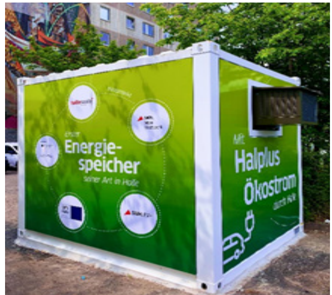
Mit dem eSpeicher am Standort Halle (Saale) kann elektrische Energie zur Versorgung der Ladeinfrastruktur zeitversetzt genutzt werden. Copyright: Peter Kolber https://www.hs-merseburg.de/innovation-espeicher-nutzung-von-speichertechnologie-fuer-intelligentes-lademanagement/
